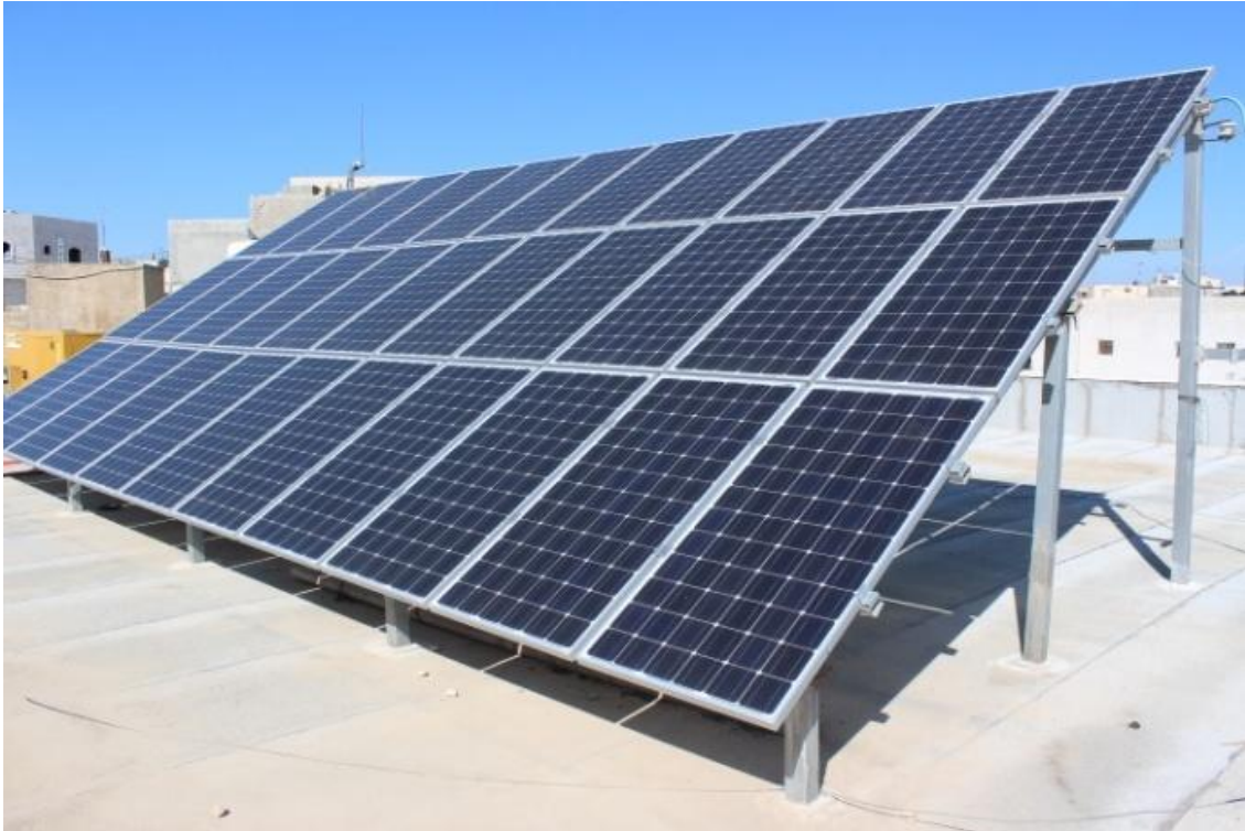
صورة الخلايا الكهروضوئية على سطح مبنى مكتبة البلدية العامة
